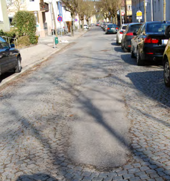
Sanierungsbedürftig: Die Hans Hatschek-Straße
